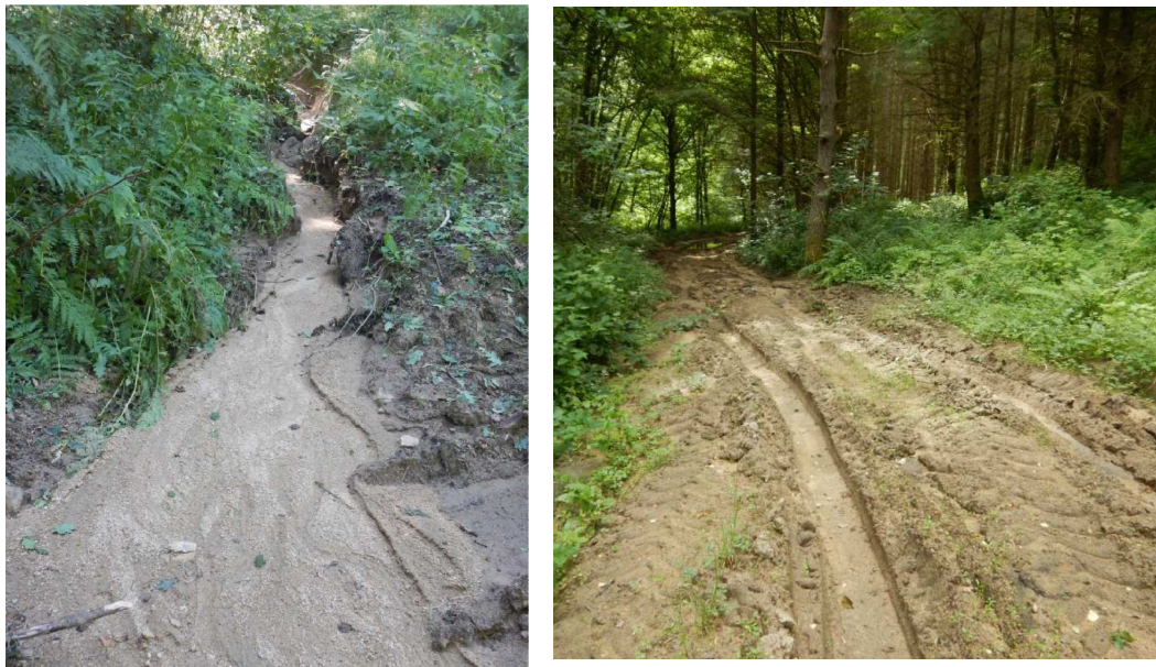
Figure 17 : cheminement de sable vers le ruisseau du Saint-Pardoux (gauche) provenant des pistes forestières dégradées en amont (droite). Date : 2.08.2016. Source : SIVOM d'Ambert.
