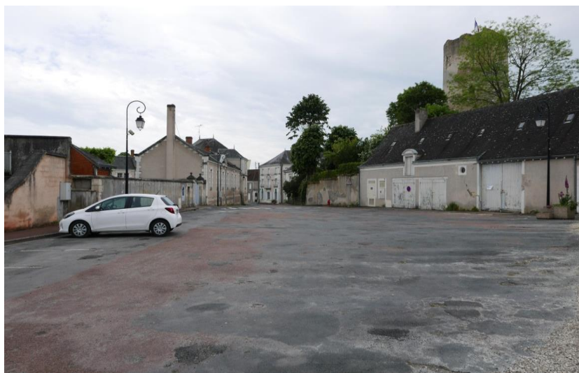
Figure 63 : Route en mauvais état (Source : Fabien Clouet)
