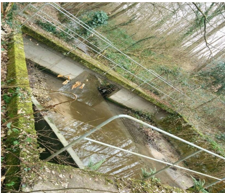
Figure 32- Bassin de rétention d'eau (source : personnelle)
