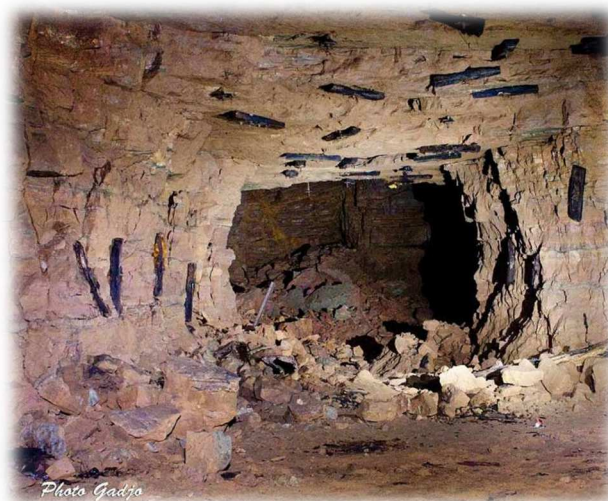
Figure 16 : Boulonnage dans une carrière souterraine (source blog Baugenaudes)
