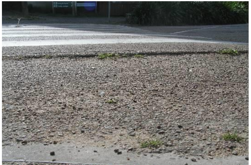
Photo 28 : ressaut sur ce trottoir
