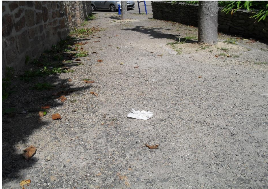
Photo 17 : Le mauvais état du trottoir incite les PMR à le contourner Source : Etienne Fauveau
