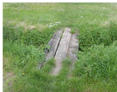
Figure 49 : Passerelles en bois dégradées. Source : photographie personnelle
