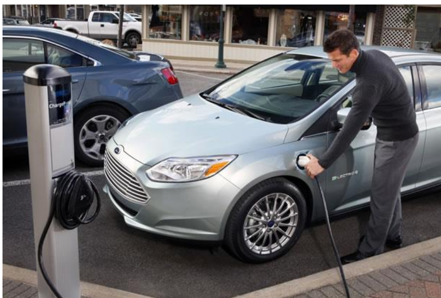
Bornes de rechargements pour les voitures électriques Source : www.automobile-propre.com
