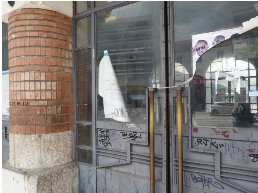
Figure 7 - Portes principales du bâtiment dégradées - Source : Jade DOUGERE
