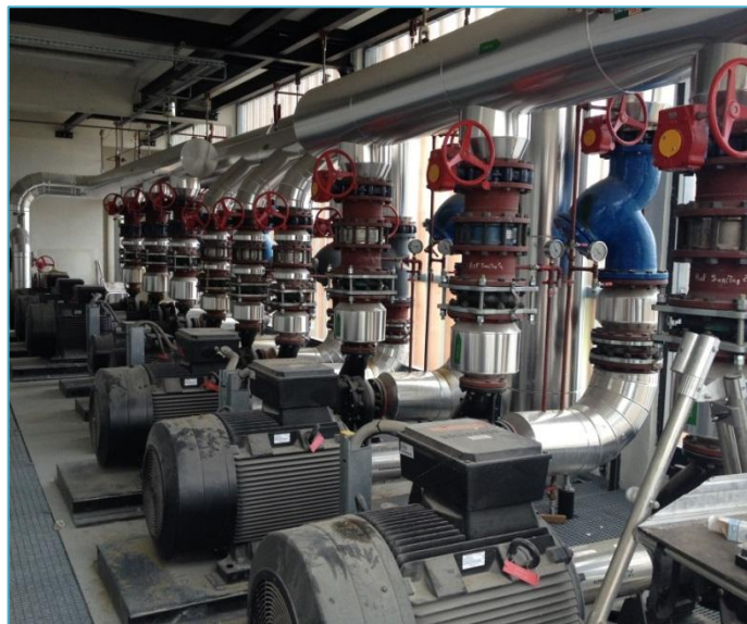
Salle des pompes – Société de Chauffage des Bords du Cher (SCBC), Tours
