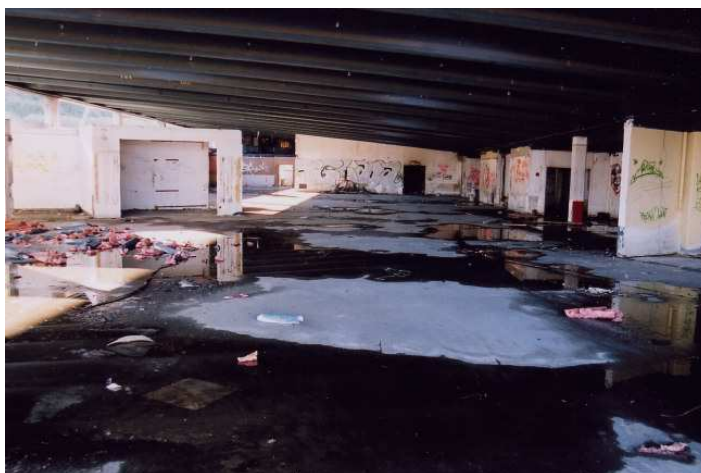
Photo 17 : bâtiment de l'hoverport vandalisé.
