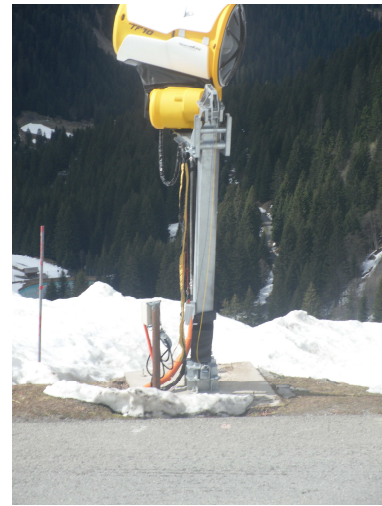
Photographie 4: Canon à neige et son arrivée d'eau souterraine [13 Mai 2013]
