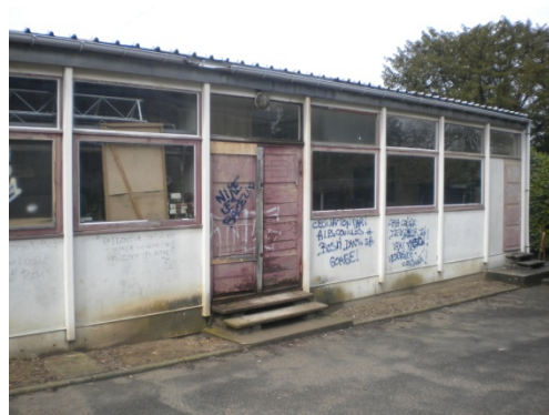
Figure 38 : Locaux municipaux dégradés
