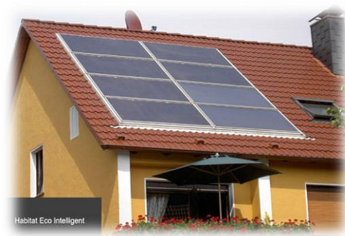
FIGURE 41: DES PANNEAUX SOLAIRES PHOTOVOLTAIQUES
