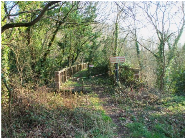
Photo 7 : n°2 Ancien pont dangereux
