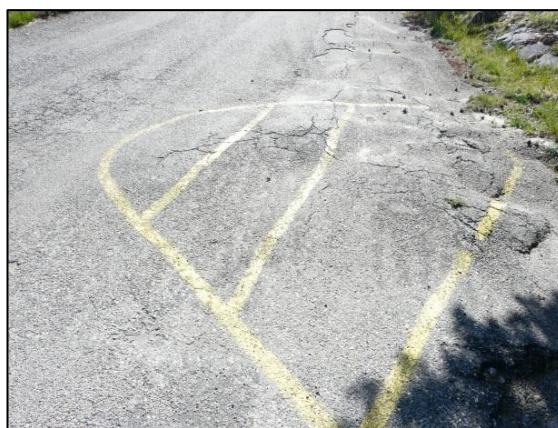
Figure 27 : Bourrelet sur l'ancienne route des forts
