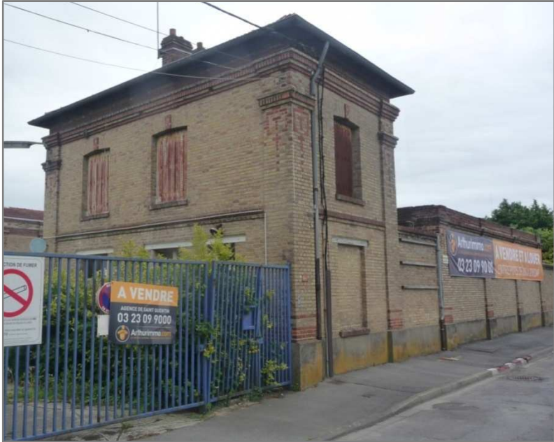
Figure 123 : Bâtiment industriel dégradé à l'entrée de Saint-Quentin
