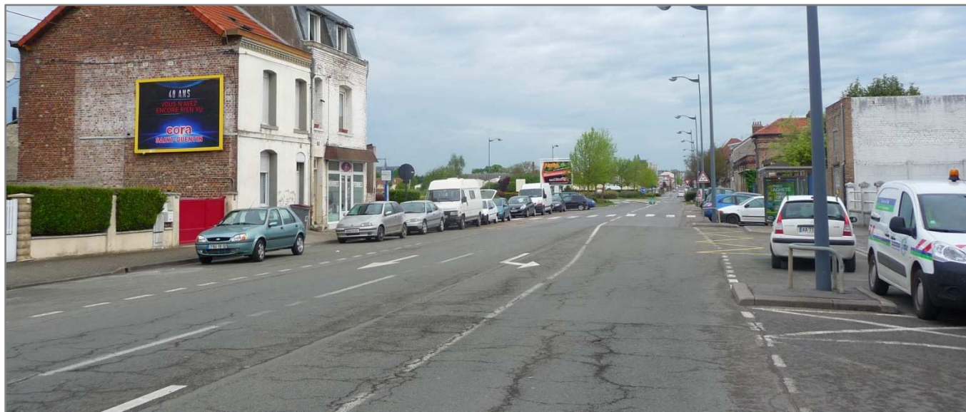
Figure 112 : Etat de la voirie dans Saint-Quentin
