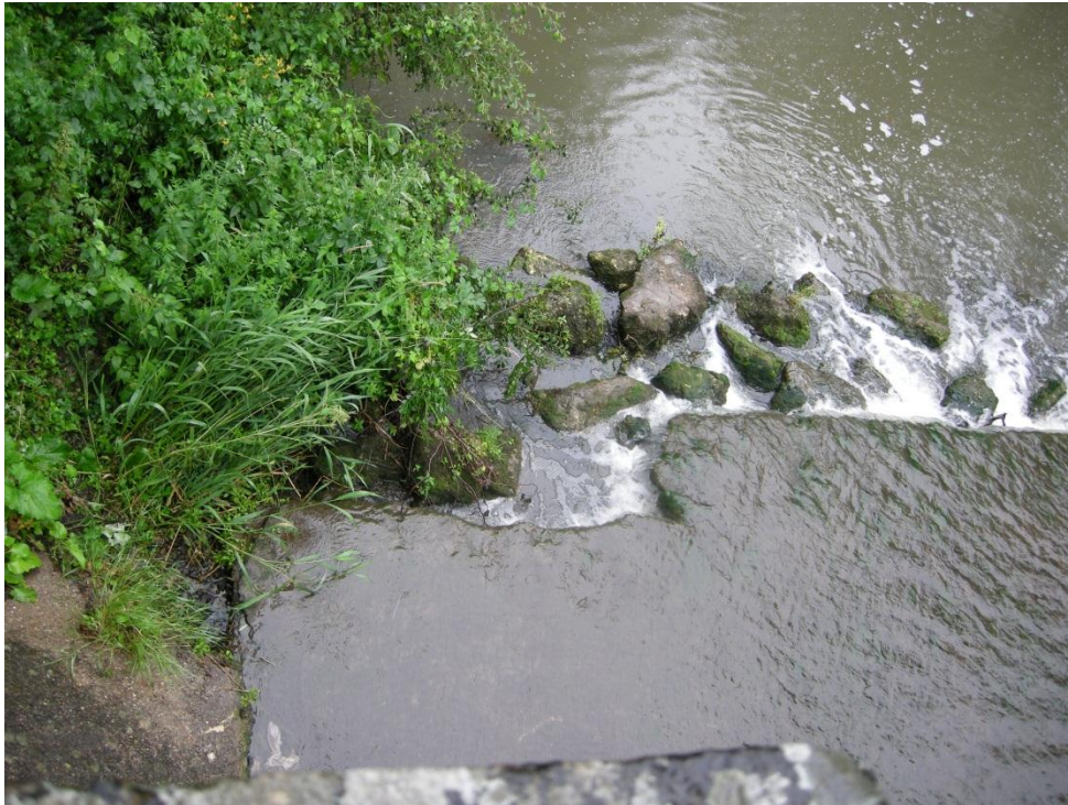
Radier endommagé en rive gauche
