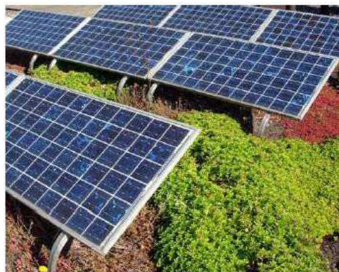
Figure 47: Panneaux photovoltaïques inclinés
