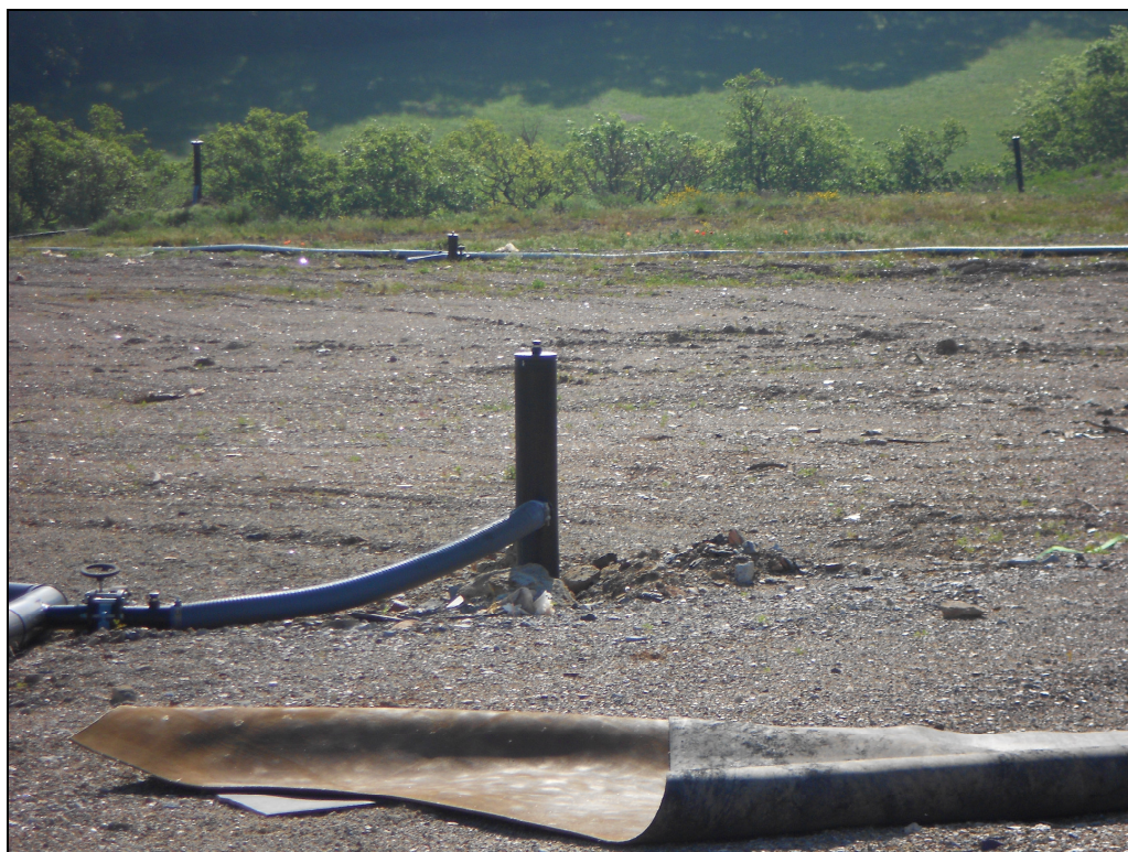
Photo 6 : Un puits de récupération des biogaz et son réseau de distribution sur le casier DI 3 avant le recouvrement du casier, auteur : RICHARD Joan.
