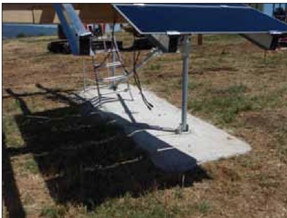
Photo 16 : Panneau solaire photovoltaïque avec fondation en semelle de béton, source : Direction générale de l'énergie et du climat 2 .
