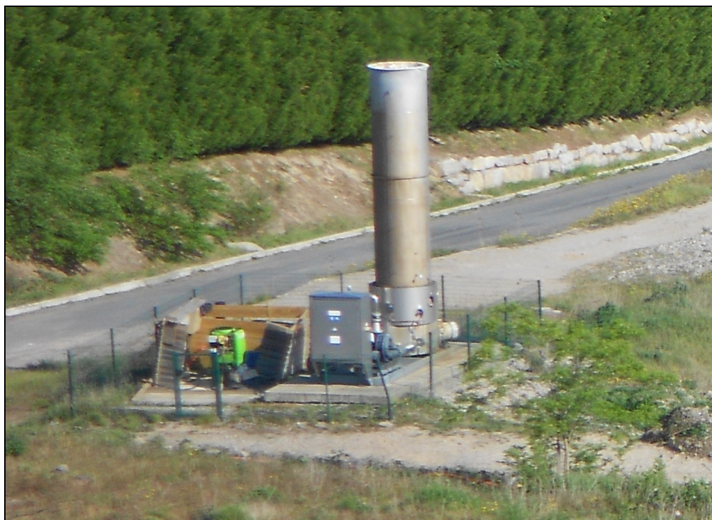
Photo 7 : Torchère de la décharge du Lou Bargas, auteur : RICHARD Joan.
