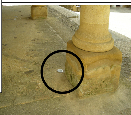
Illustration 56 Spot intégré à l'ouvrage.
