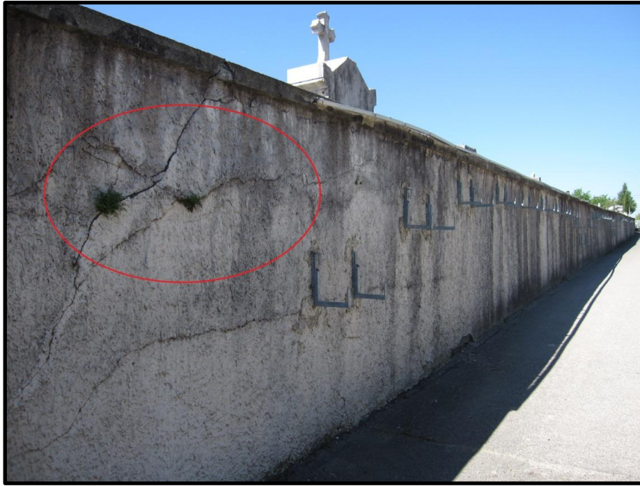
Figure 14 : Enceinte murale du cimetière présentant des fissures (cercle rouge), vue depuis l'entrée secondaire
