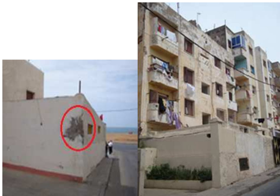
Figure 22: photo montrant l'insalubrité des habitations à la rue de Rome Réalisation ALAMI.S
