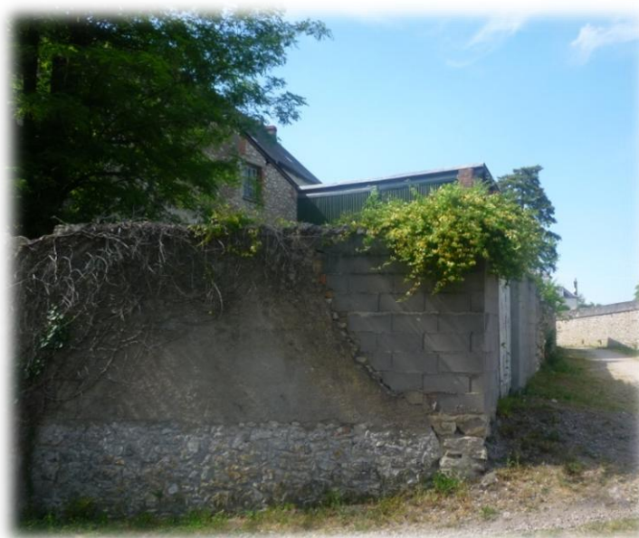
Photo CLXXX : Rénovation maladroite d'un mur avec des parpaings, Suèvres Réalisation Aurélie CONNEN DE KERILLIS
