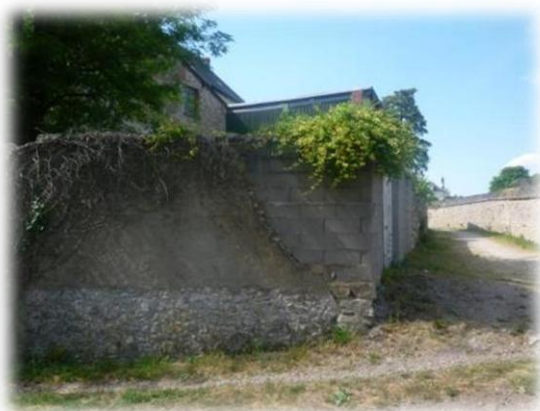
Photo 64 : Réhabilitation maladroite d'un mur à l'aide de parpaings à Suèvres Réalisation Lucie GRENIER
