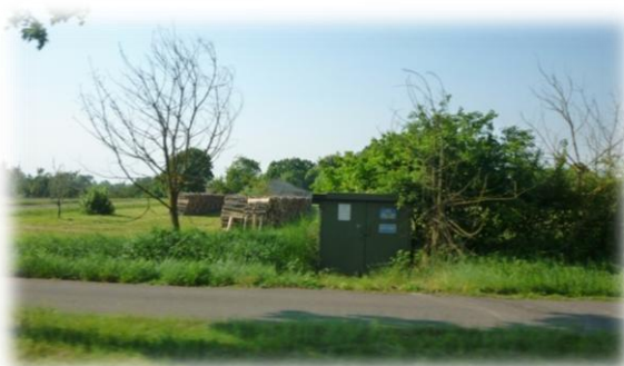
Photo 118 : Armoire électrique verte peu visible dans le paysage car accolée à un buisson Réalisation Florian CARDARELLY
