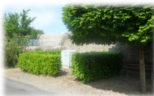
Photo 117 : Armoire électrique camouflée par une haie de lauriers Réalisation Loïc BASSET
