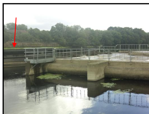
Figure 3: Ecran déflecteur de la prise d'eau en Vienne
