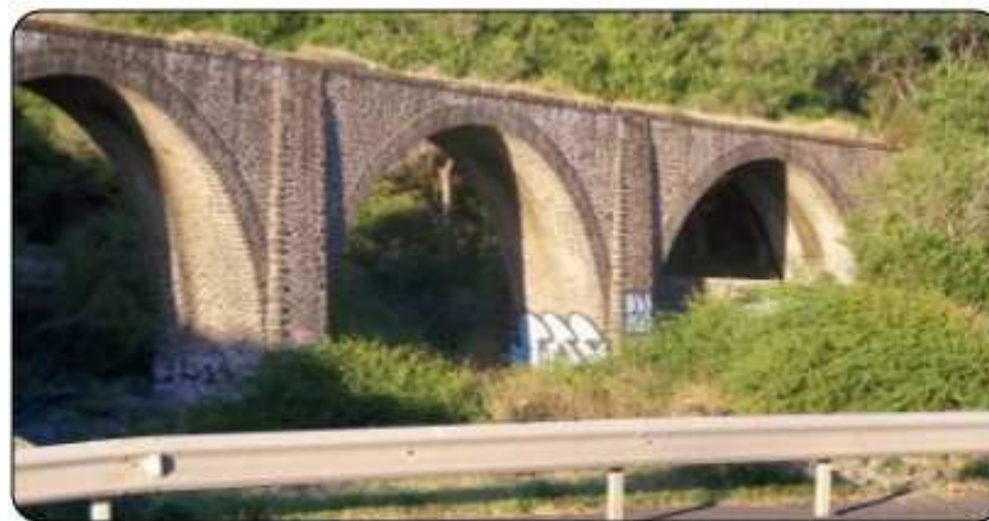
Figure 121: Exemple de graffitis sur le pont de la ravine de colimaçons, Auteur : Sabine Corby
