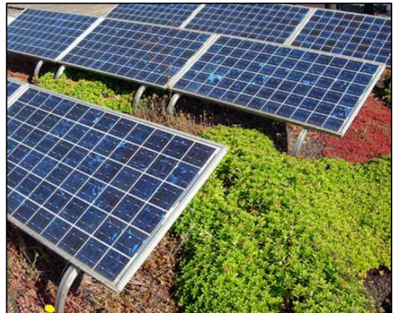
Image 14 : Panneaux photovoltaïques (source : gaia-network.com)
