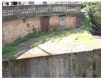
Figure 56 : Graffitis localisés au niveau du pont Bayard
