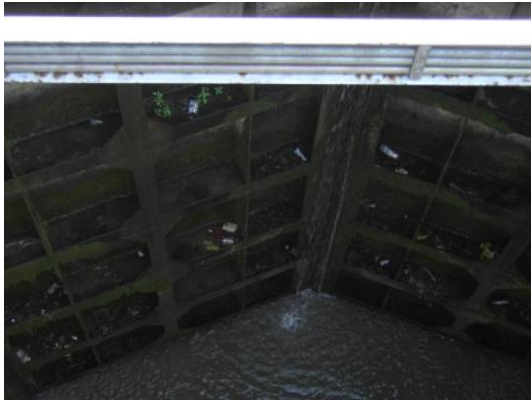
Figure 73 : Les déchets s'accumulent sur les portes de l'écluse
