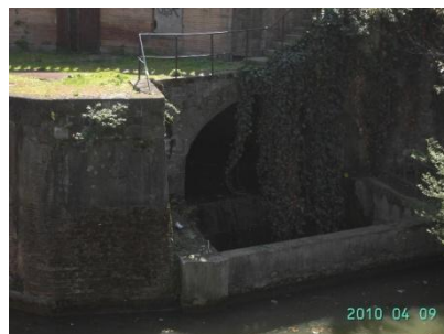
Figure 92 : Les plates-formes sont envahies par le lierre
