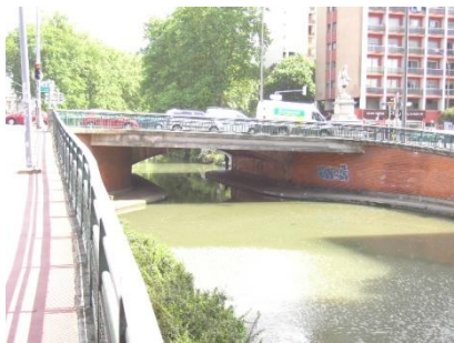
Figure 55 : Graffitis abondants sous le pont des allées Jean Jaurès
