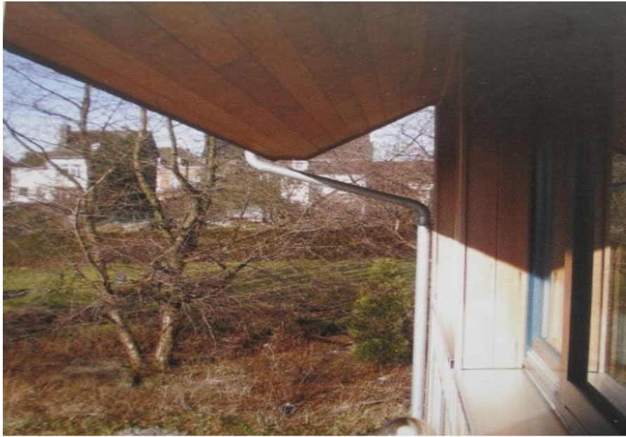
Photo 20 : Débordement de la toiture dans une maison de Neufchâteau. Source : Maisons passives : principes et réalisations.
