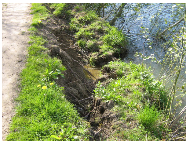
Photo 18 : Effondrement de berges
