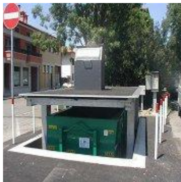
Figure 16 : Type de container enterré (Source : http://www.mundetis.com )
