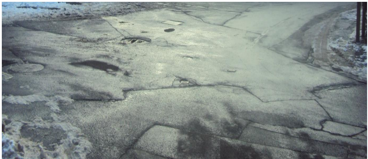
Photo 21 : Revêtement en mauvaise état.
