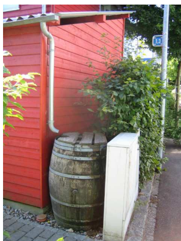
Figure 46: Citerne de récupération des eaux pluviales de Vauban 85
