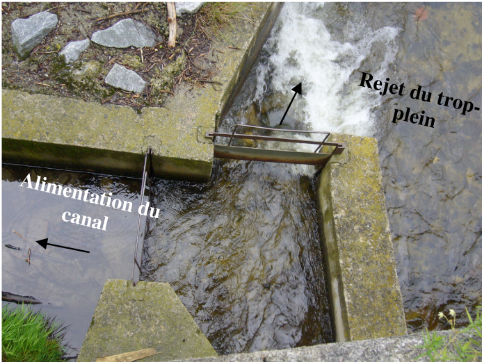
Trop-plein du canal alimentant la passe à poissons (18.06.2010)
