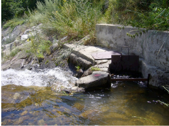
Prise d'eau en rive droite du canal des Ansanères (21.07.2010)
