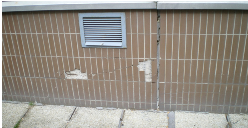
Figure 43 : Fissure sur les Halles, photo personnelle
