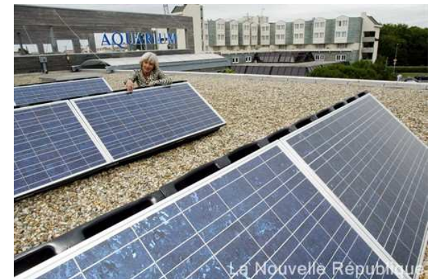
Image 12 panneaux photovoltaïques inclinés sur un toit (source : google image)
