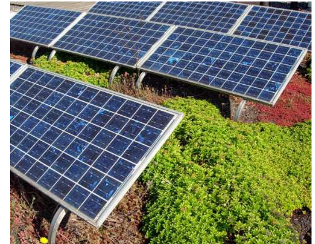
Image 11 panneaux photovoltaïques inclinés (source: google image)
