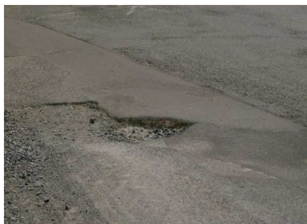
Photo 11 : Revêtement en mauvais état
