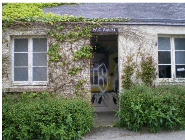
Photo 23 : Les sanitaires détériorés du parking
