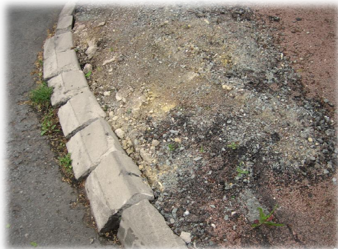
Photo 8: voirie détériorée (photo personnelle)
