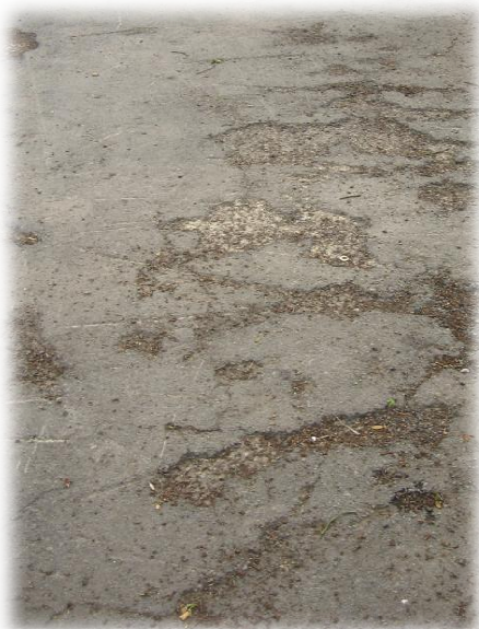
Photo 7: voirie détériorée (photo personnelle)
