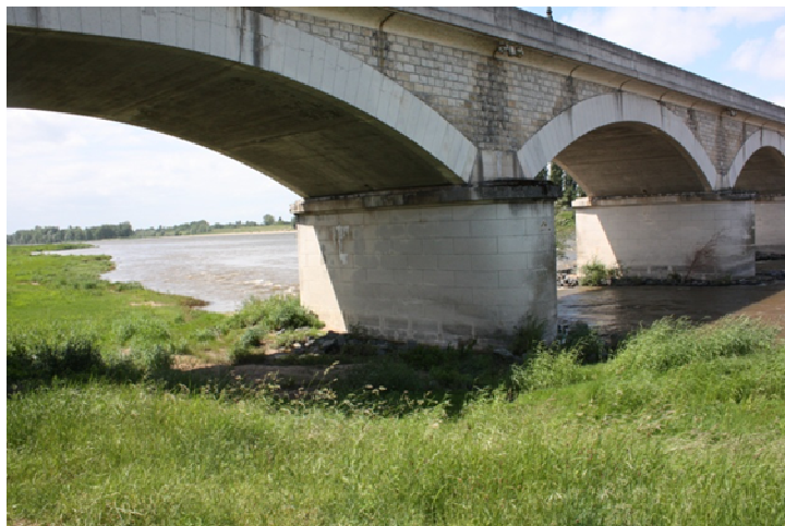
Illustration 21 - Amboise, point dur de la navigation en raison de l'état de ses entre-deux piles
