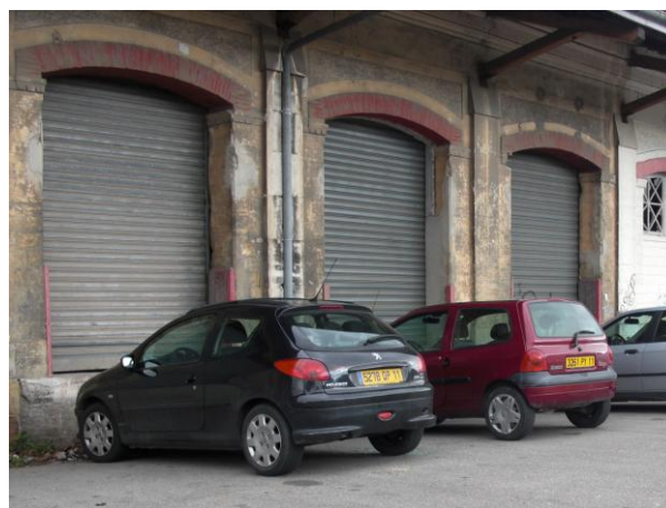
Figure 37 Façade des halles abîmée - Réalisation personnelle
