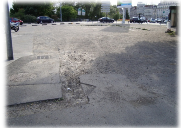
Photo 37 : La place devant l'entrée de la piscine, un espace détérioré (source : réalisation personnelle)
