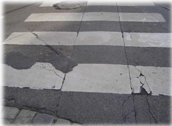
Photo 36 : Un passage piéton abîmé de la rue Albert de Mun (source : réalisation personnelle)
