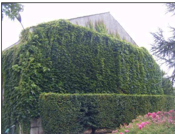
Photographie 86 : Façade arrière qui menace de s'effondrer sur le square
