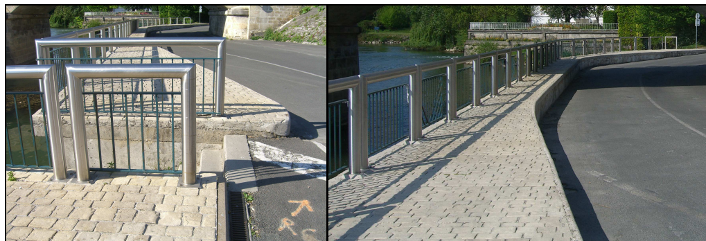
Photographie 50: Rupture de la promenade piétonne avant le pont Saint-Jacques
