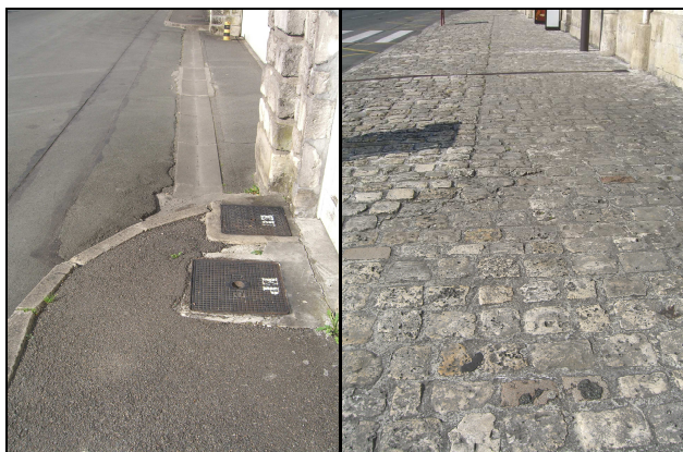
Photographie 56: Revêtements des trottoirs (enrobé ou pavé) non adaptés aux personnes à mobilité réduite
