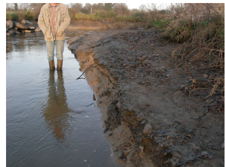
Figure 16 : Quantité de sédiment importante au pont de l'écluse (Ouverture des vannes 08/09)
