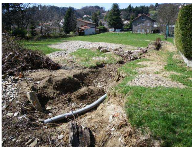
Figure 9 : Photo de la rupture de digue qui s'est produite en rive droite au profil 30.8
