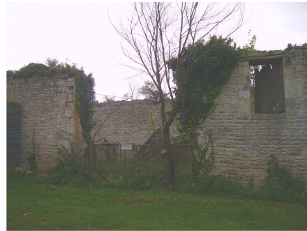
Photographie 33: Bâtiment en ruine
