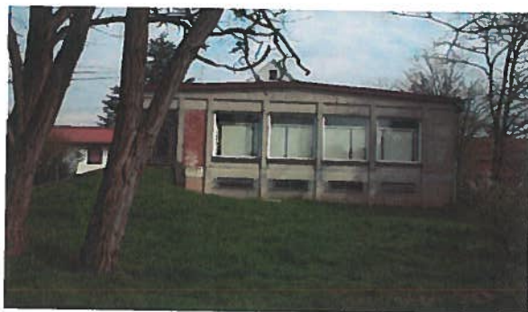
Photographie 21 : Facade arrière d'un bâtiment annexe de l'établissement Engel, décrépi
