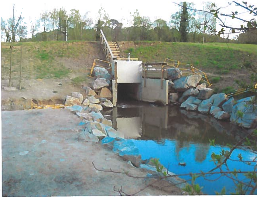
Photo 1 : Le dispositif permettant de limiter le débit du Cens. (Photo : H  l  ne Bergeot)
