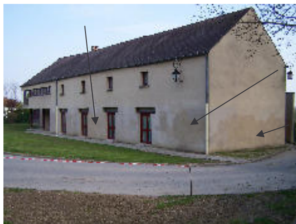
Photo 4 : Maison du Village avec la localisation des anciens tags 17
