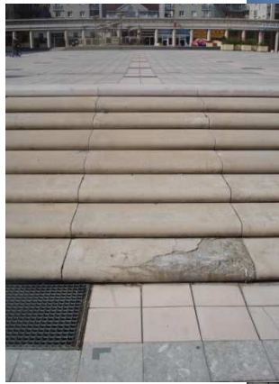
Marches dégradées et système d'écoulement des eaux pas esthétique
