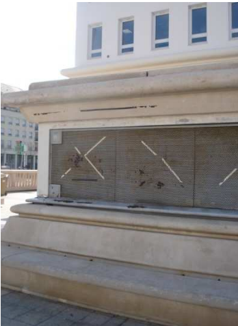
Grillage d'aération du banc dégradé et peinture noircie
