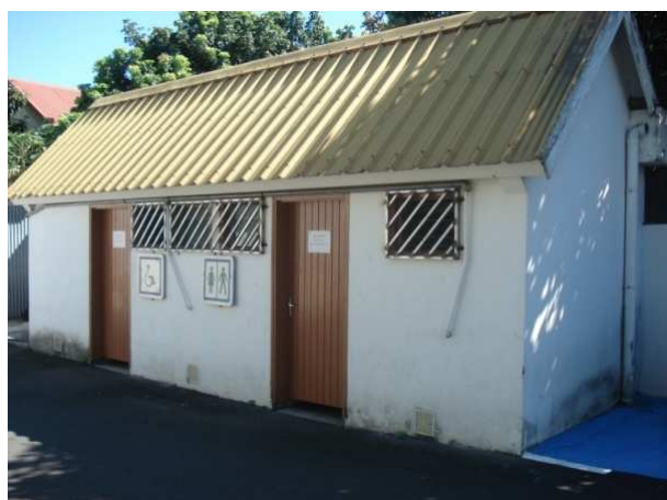
Photo n° 20 : Toiletttes publiques en mauvais état
