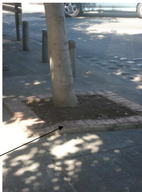
Photo n° 42 : Soulèvement du trottoir à cause des racines
